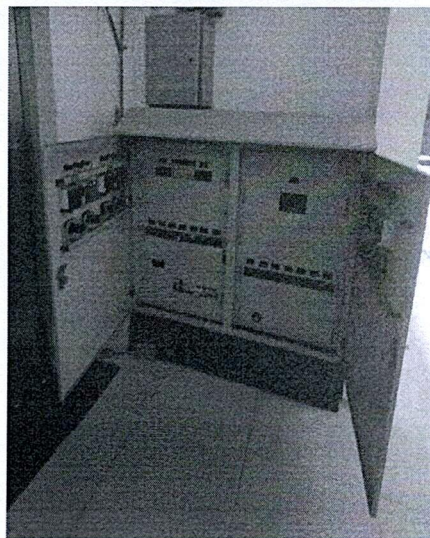
Hình: Các thiết bị, máy móc thuộc hệ thống điều hòa không khí, PCCC, hệ thống điện...
